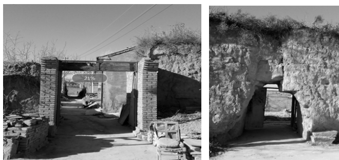
图 7-17 延庆区双营村土城人为破坏现象
